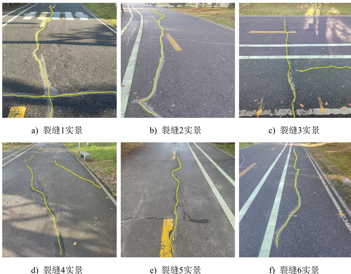
图3.19 区域二道路裂缝实景
