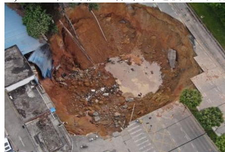
d) 2024年12月深圳施工路面垮塌
