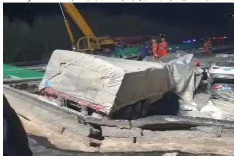
c) 2023年12月G55二广高速路面塌陷
