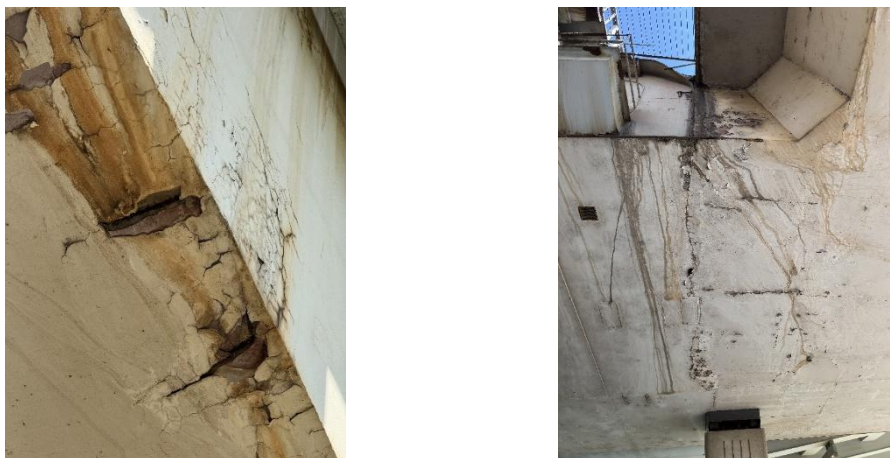
图 3.15 B13 开裂与沉降情况
