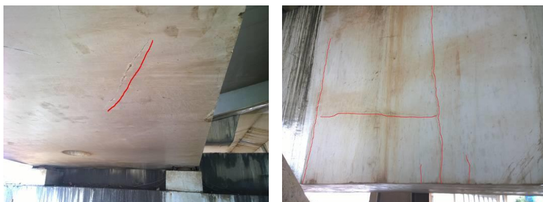
图 3.14 B12 的沉降与裂缝
