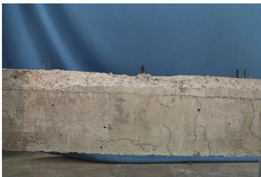
b) 梁上部混凝土爆裂
