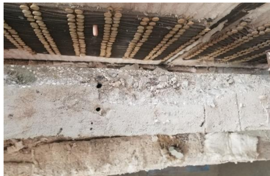
c) 梁顶混凝土爆裂
