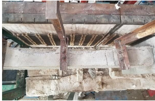
c) 梁顶混凝土爆裂
