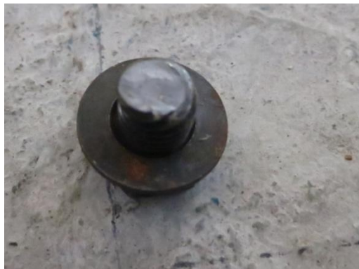
d)螺栓套筒连接件破坏照片
