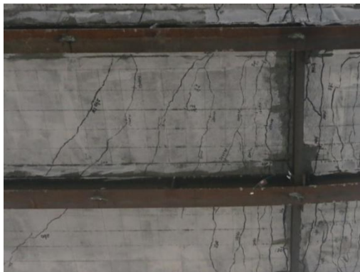
c)位置 C 裂缝照片
