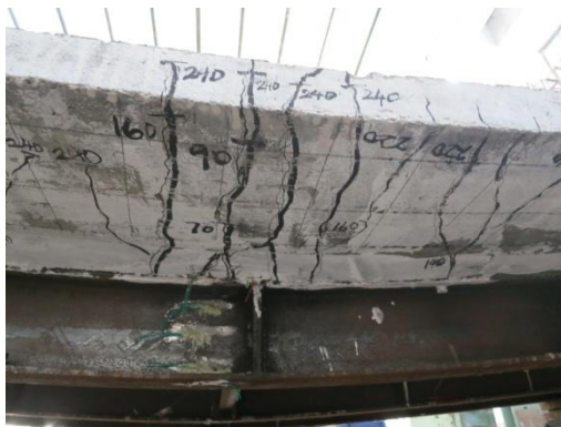
a)位置 A 裂缝照片
