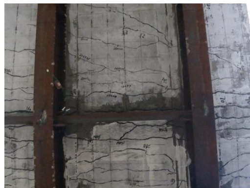
b)位置 B 裂缝照片
