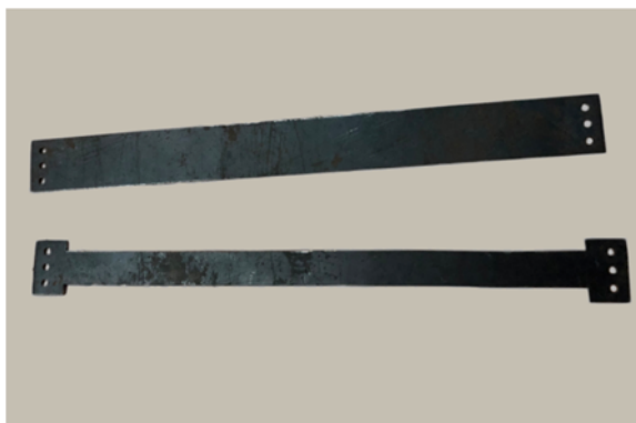
a) 柱构件损伤实物图
