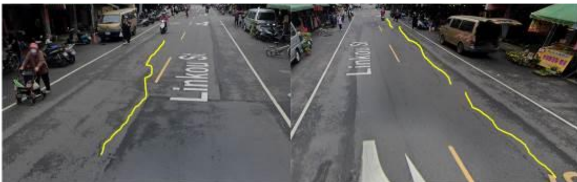
c) 裂缝 C3 实景
