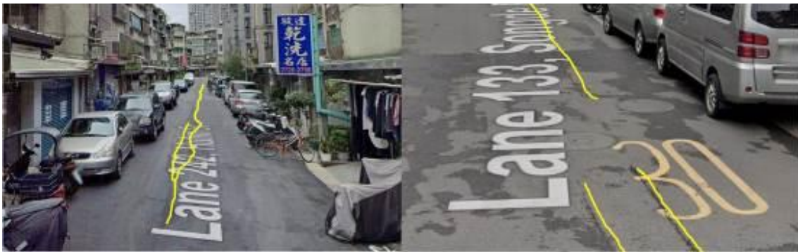
a) 裂缝 C1 实景
