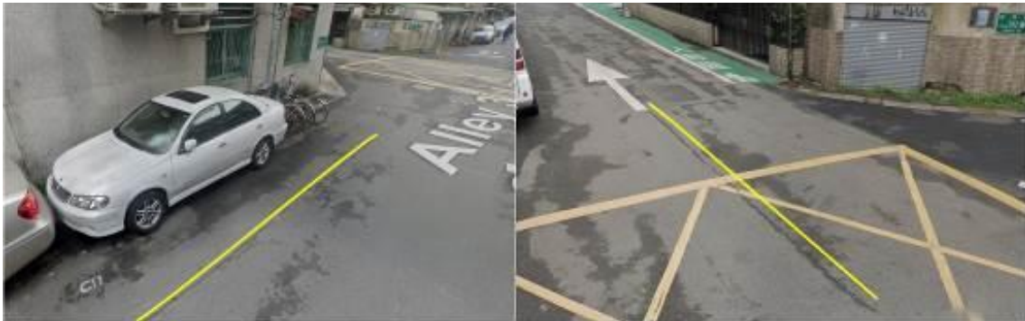
b) 裂缝 C2 实景
