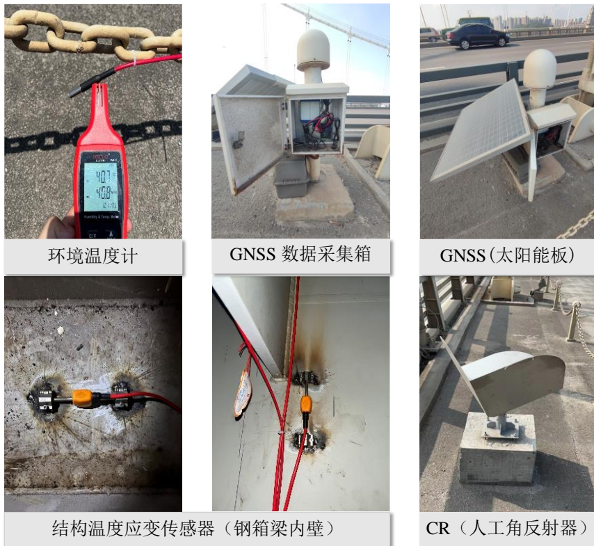
图 3.3 大桥传感器、GNSS和CR布置实况
