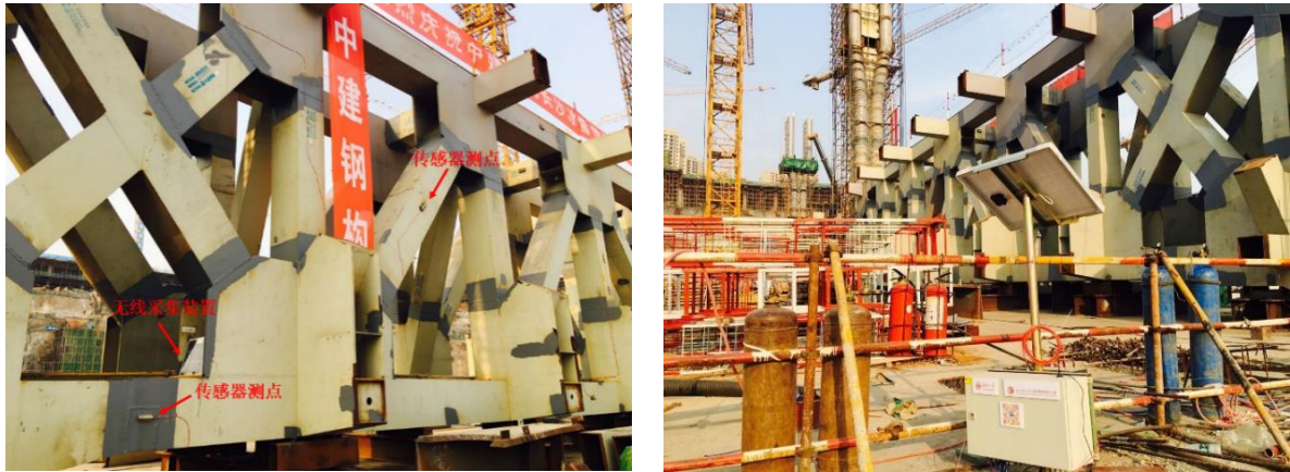
(a) 钢桁架处传感器监测测点
