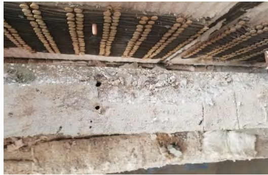
c) 梁顶混凝土爆裂
