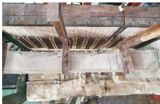
c) 梁顶混凝土爆裂
