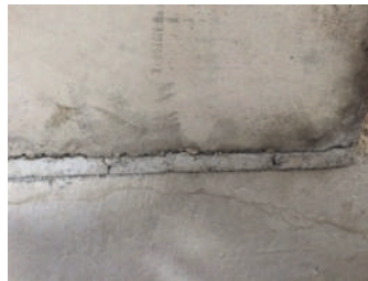
c) 坐浆处的水平滑移裂缝
