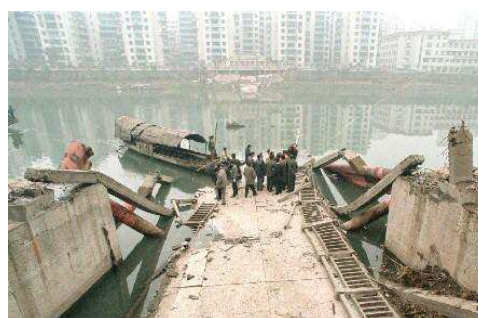
b)彩虹桥垮塌事故现场
