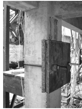
图 3 由钢板引起的损伤
